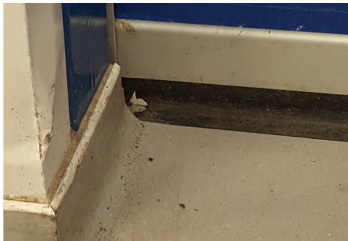
Een rubberen afdichting houdt een muis echt niet tegen
