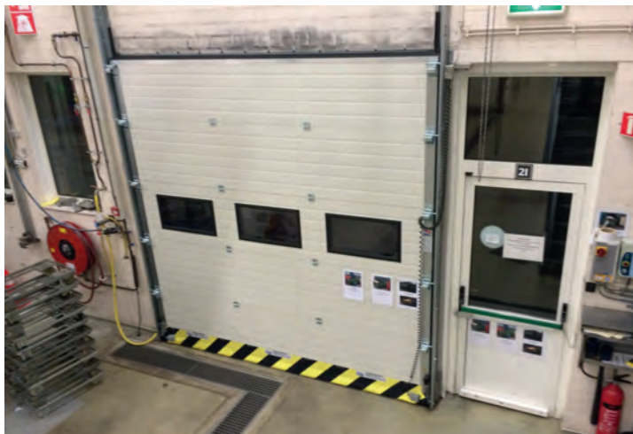
Een afdichting op een bedrijfsdeur. Echt helemaal dicht dus
